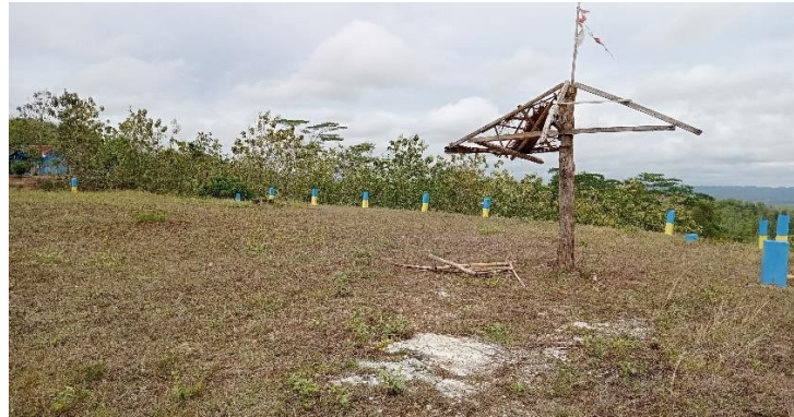
Gambar 2. Gazebo yang sudah rusak dan tidak berbentuk seperti sedia kala
